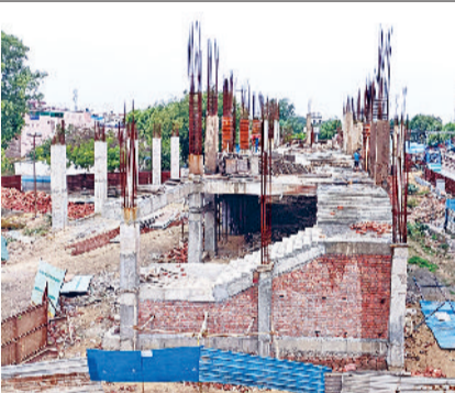
बहादुरगढ़। सुधारीकरण के तहत रेलवे स्टेशन पर जारी नए भवन का निर्माण।
